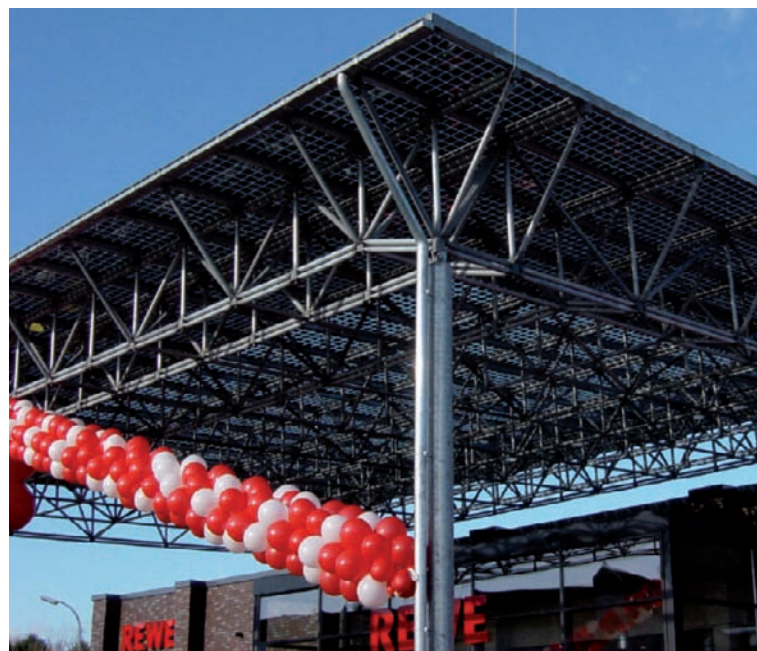
Abbildung 2 Solarmodule an einem Lebensmittelmarkt in Gelsenkirchen
