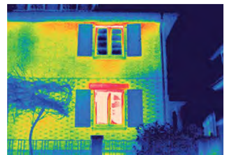
Abb. 9: Erhöhter Wärmeabfluss im Bereich des Fenstersturzes durch Thermografie sichtbar gemacht.
