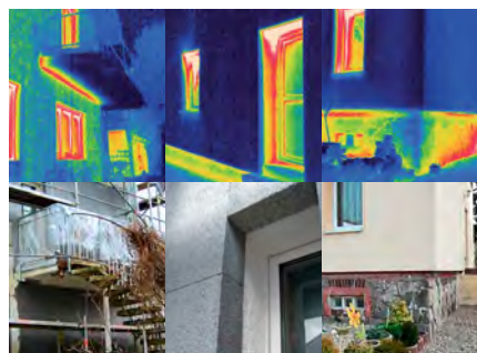
Abb. 56: Foto- und Thermografieaufnahmen von massiven Wärmebrücken bei einer Gebäudesanierung: dämmstoffdurchstoßende Balkonplatte (1); ungedämmte Fenster- und Türschwelle (2); ungedämmter Sockel aus Bruchsteinmauerwerk (3).
